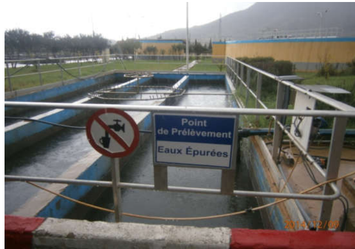
Figure 03 : Eau épurée dans la STEP de Ain Defla.
